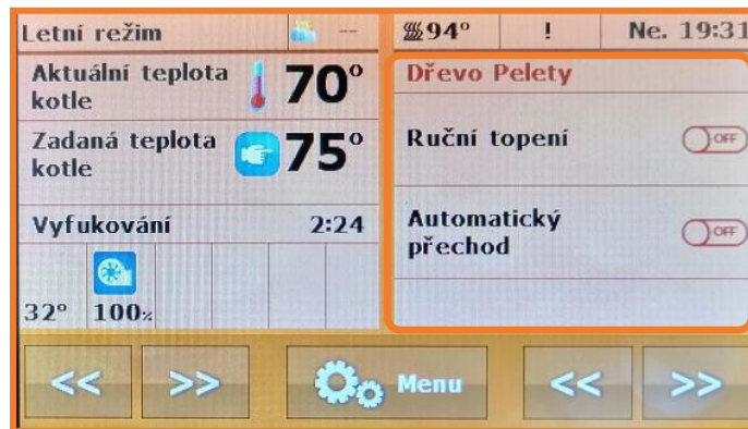
Indikace Ručního topení a automatického přechodu z dřeva na pelety.
